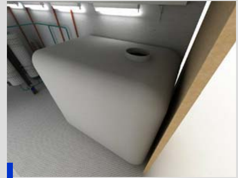
Depósito de cloración del agua potable
