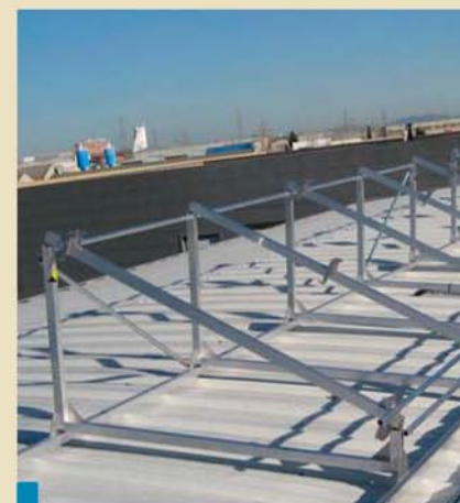
Estructura para módulos solares
